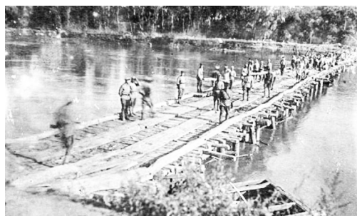
Строительство переправы через Днестр войнами 51-й инженерно-саперной бригады в районе Кицканско-Копанского плацдарма
